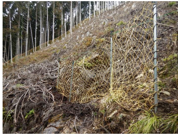
土留柵 【赤西国有林（宍粟市）】
