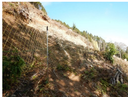
上張りワイヤーロープの防護柵 (有ヶ原国有林)
