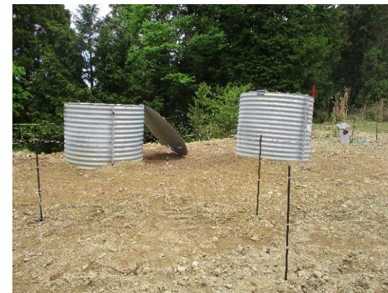
R6年度 コルゲート管(大型排水管)
