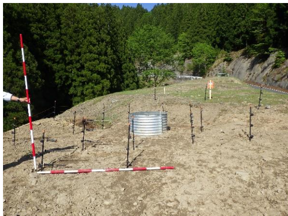
R5年度 コルゲート管(大型排水管)
