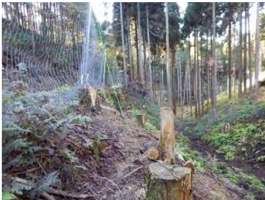
写真16 柵の破損箇所(支柱を支えるロープが外れている)
