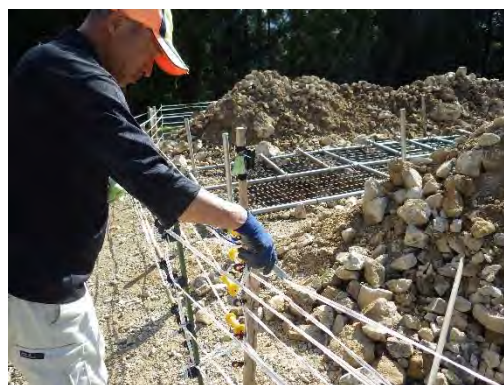
電圧の確認状況
