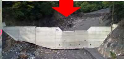
第3号谷止工 H30被害状況
