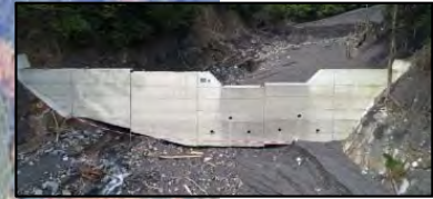
第3号谷止工 H30被害状況
