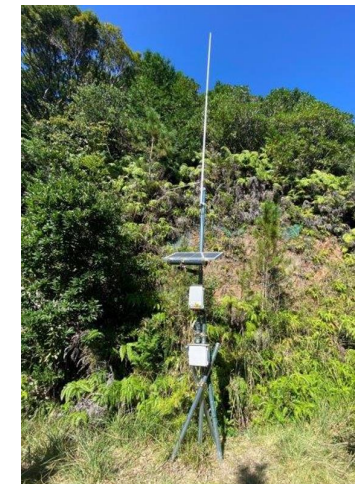
親機の設置状況
