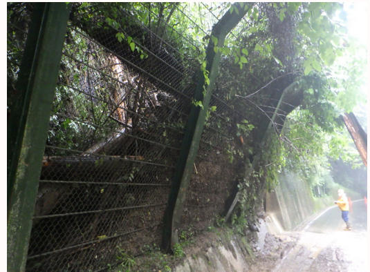
被害直後の落石防護柵の状況
