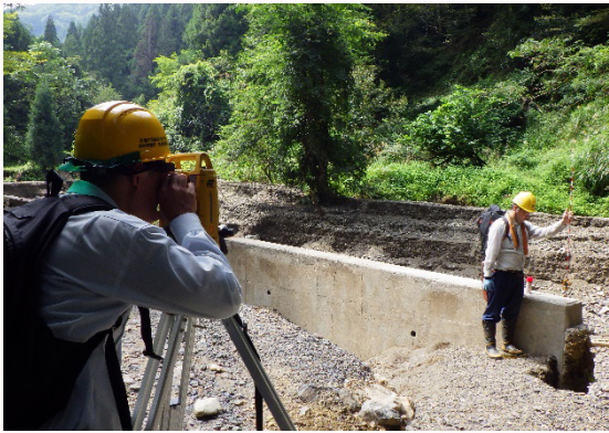
既設の路肩擁壁の被災状況と位置の確認 滝ヶ谷林道（南越前町）
