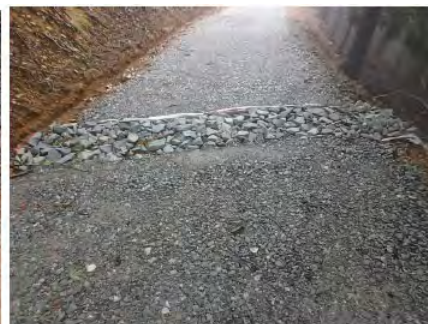
栗石路面排水工 (兵庫県豊岡市)
