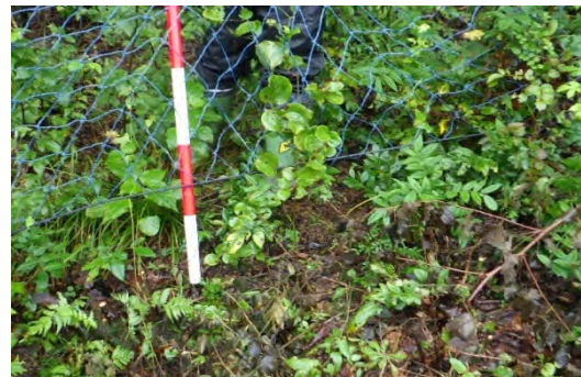
写真－13 アンカー杭の抜け
