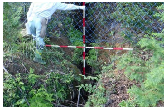
写真－15 水路への設置(穴の仕舞不良)
