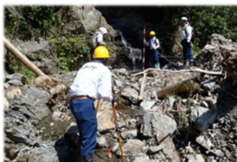
被災箇所の現地測量 (H29.7九州北部豪雨災害の実施例)
