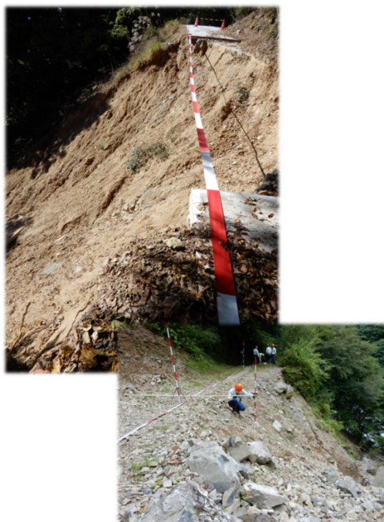
被災した林道の現地調査
