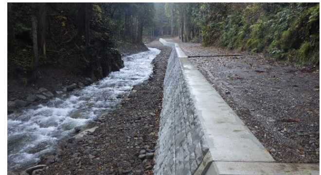
被災した林道の復旧状況 なんししょうくんみなみえげんちよう たきがたに （福井県南条郡南越前町 瀧ヶ谷林道）
