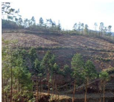
伐採が終了し安全が確認できる箇所から専用器具により植付
