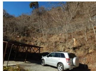
【民家付近での落石対策工】
