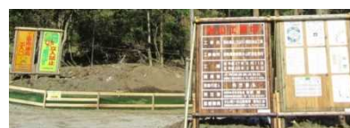
間伐材を利用した 落石防護柵(上)、工事看板(下) 静岡署(静岡県小山町)
