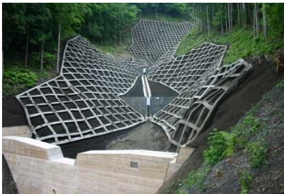
山腹崩壊地の復旧 (溪間工(治山ダム)、山腹工(法枠工)) 日光署(栃木県日光市)
