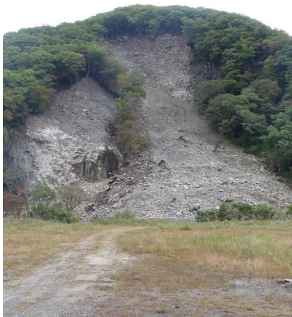
法面崩落災害(戸倉山) (H23年7月)
