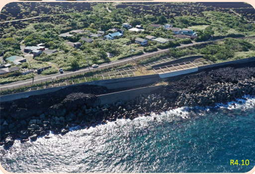
H29年台風により コンクリート防風柵転倒
