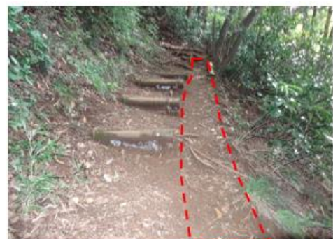
(写真3 脇道が拡大した事例)
