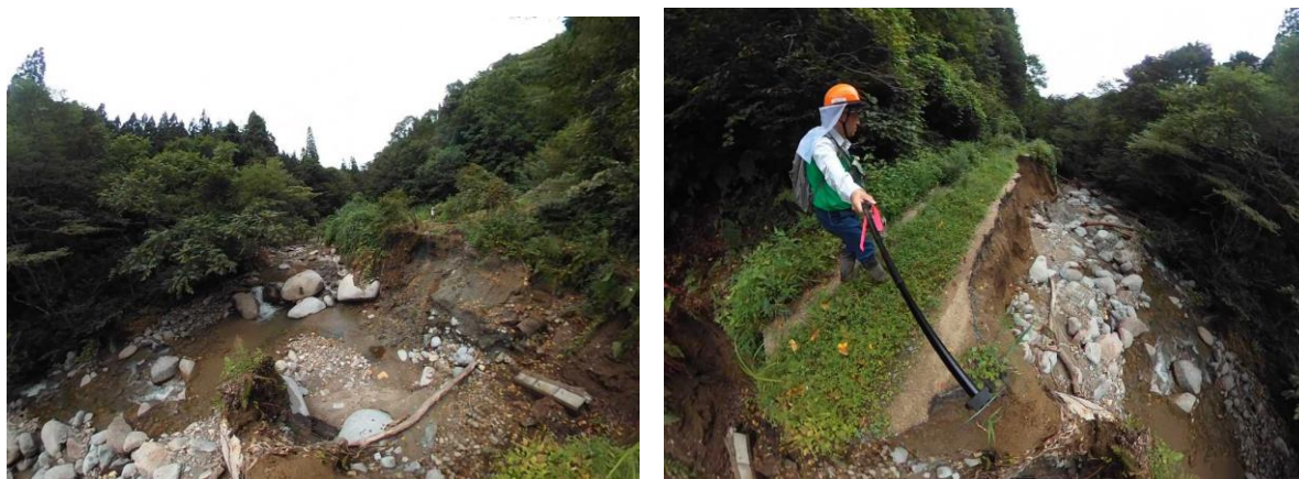
図-5 同地点で視点を変更した林道災害現場の様子
