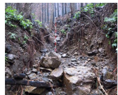
図 2 洗堀被害の状況
