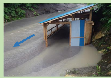
下流の天然温泉被災状況 (R3.8)
