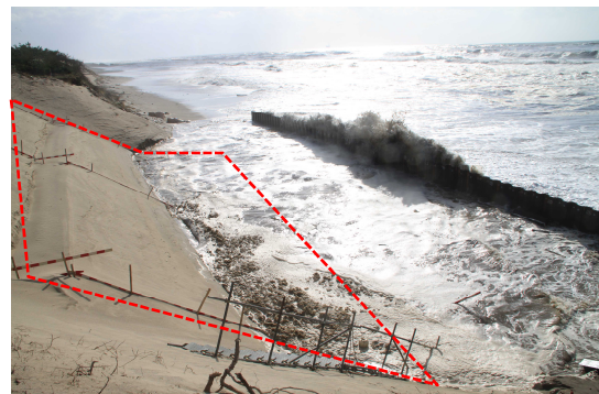
（写真-10）平成 27 年度施工箇所浸食被害
