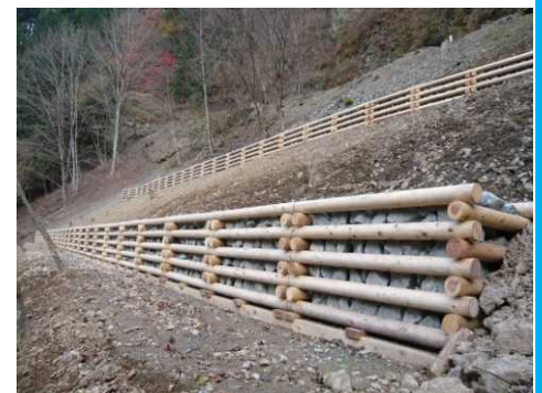
間伐材を使用した治山工事 (秩父市荒川上田野：中川国有林)
