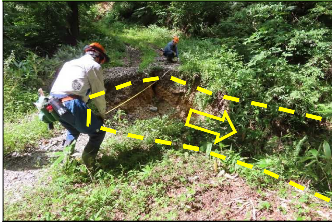
路体崩壊：小綱木林道
