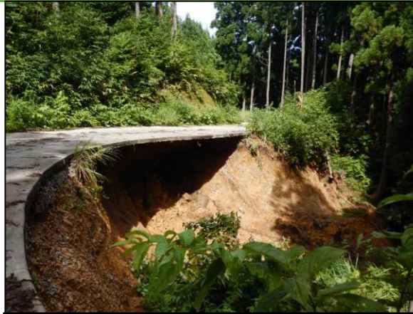
路体崩壊：内須川林道
