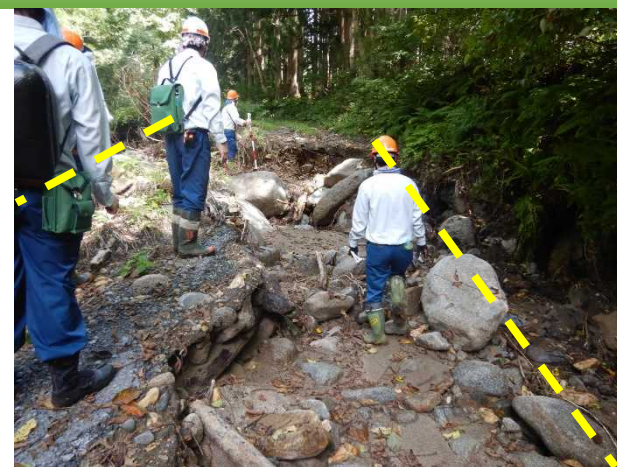
路体崩壊：馬取川林道
