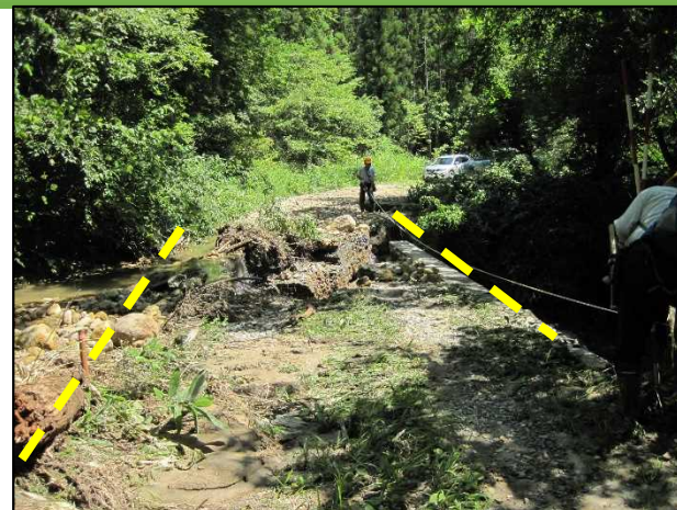
路体崩壊：吉見山林道
