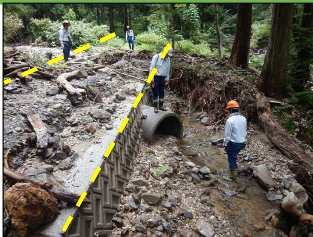
路体崩壊：馬取川林道
