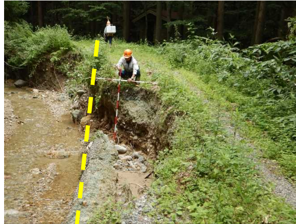
路体崩壊：西山林道
