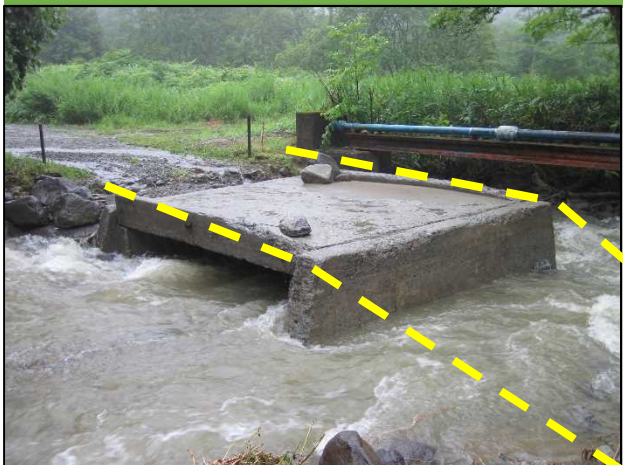
路体崩壊：吾妻山（小倉川林道小倉川支線）林道
