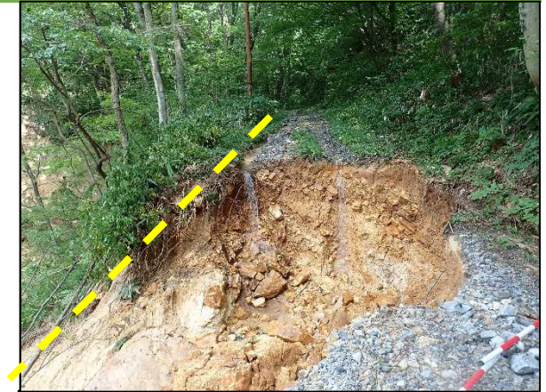
路体崩壊：蝙蝠沢林道脇ノ沢支線
