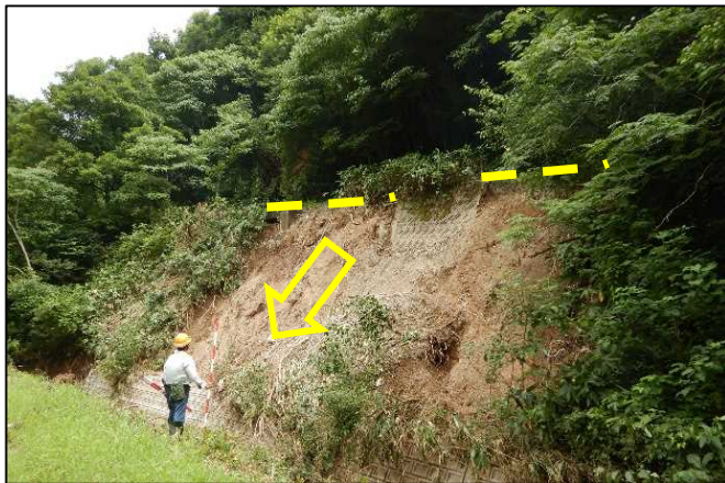
路肩崩壊：西山林道
