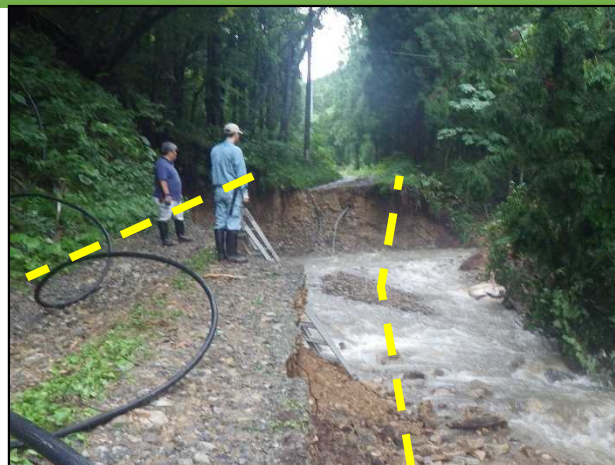
路体崩壊：秋元湖岸林道
