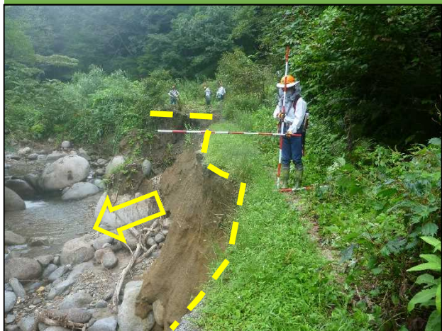
路体崩壊：馬取川林道
