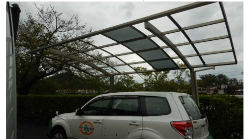
▲台風15号により飛ばされたカーポートの屋根（富津市・湊森林事務所）
