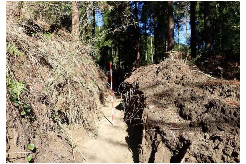
▲大雨後の作業道洗掘（君津市・戸崎国有林）
