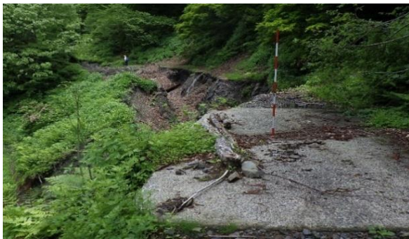
久良谷林道の被災状況
