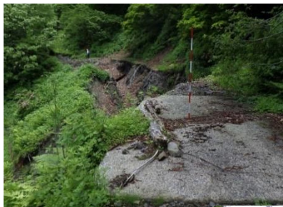
久良谷林道の 被災状況
