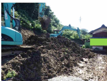
被災状況 (村上市荒島地区)
