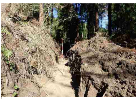
▲大雨後の作業道洗掘（君津市・戸崎国有林）
