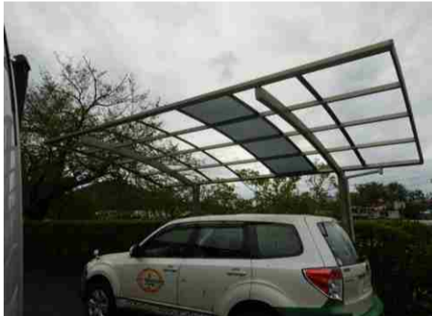
▲台風 15 号により飛ばされたカーポートの屋根
