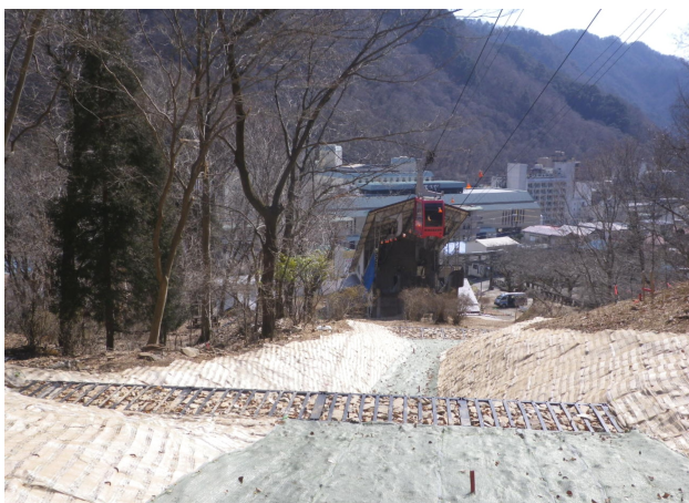
上記写真の復旧の状況（栃木県日光市）
