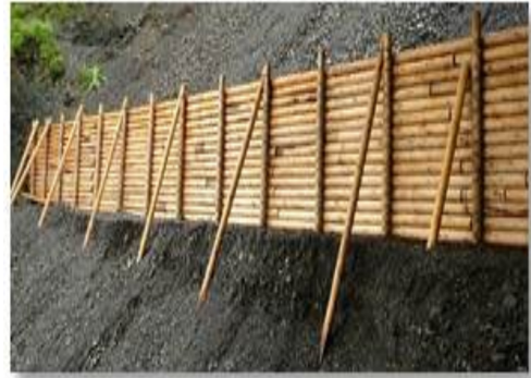
間伐材を利用した落石防護柵
