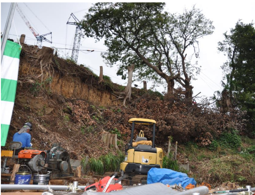
住宅隣接地における小規模架線による危険木伐採・搬出
