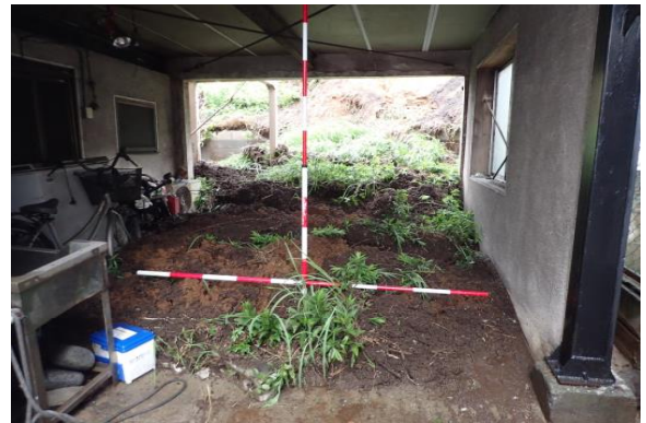
土砂の流入した民家
