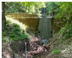
土砂から守る治山ダム
