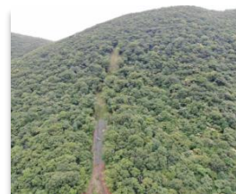
復旧治山工事 鍋割山(前橋市) (ロープネット工で斜面の岩石を抑えて落石を防いでいます。)
