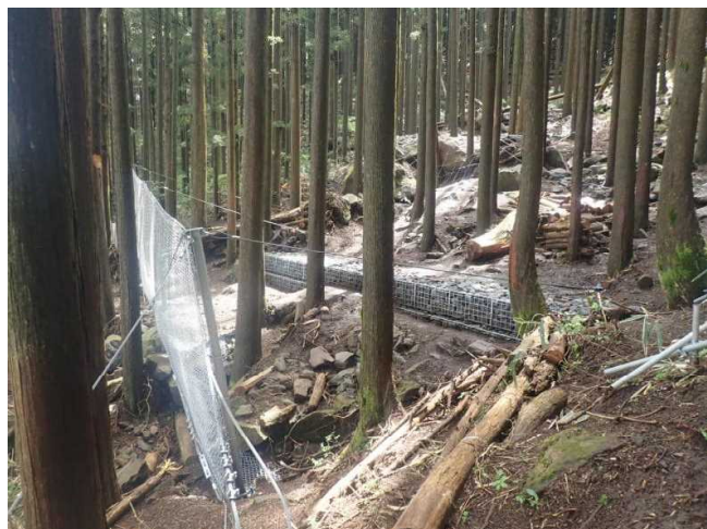
仙石原（台ヶ岳）の落石防護柵など
