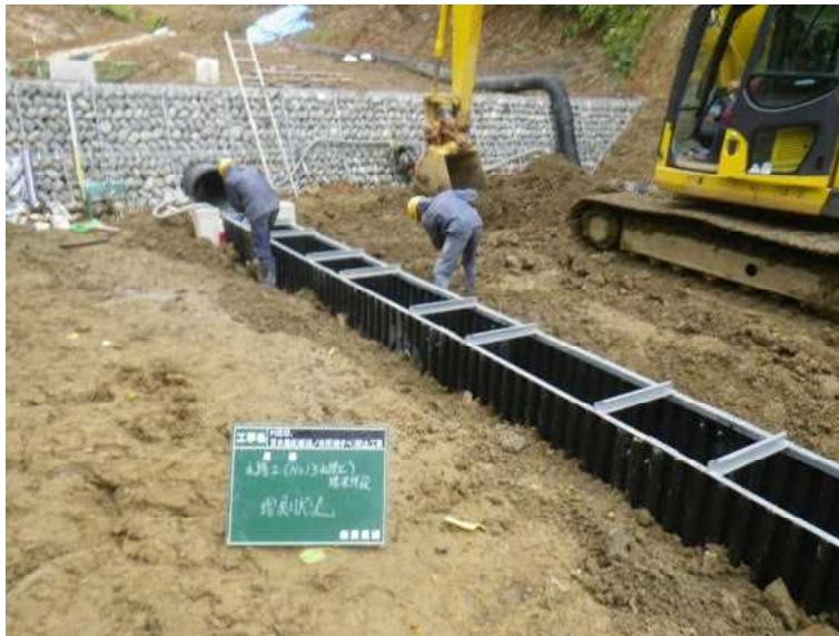
水路を作るために、ポリエチレン製の溝となる資材を設置していく
