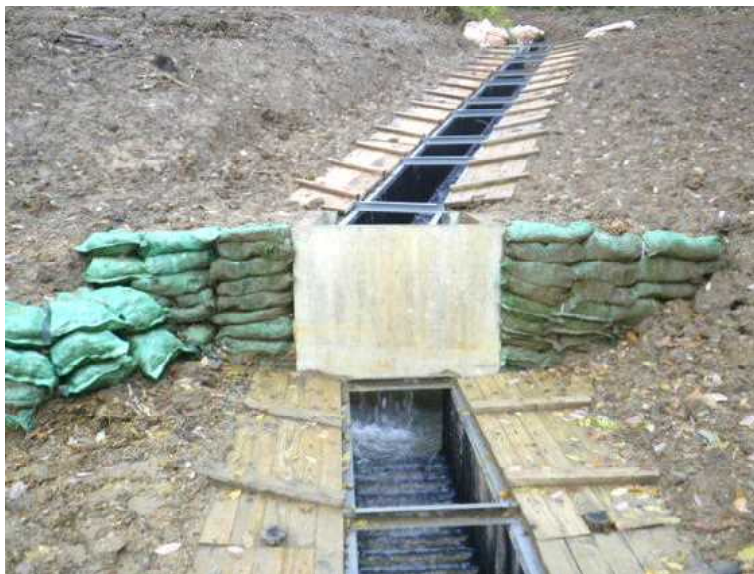
水路の両脇に木質の板材を設置し、斜面上で段差が生じるところには植物の種子が含まれた土のうを積む
