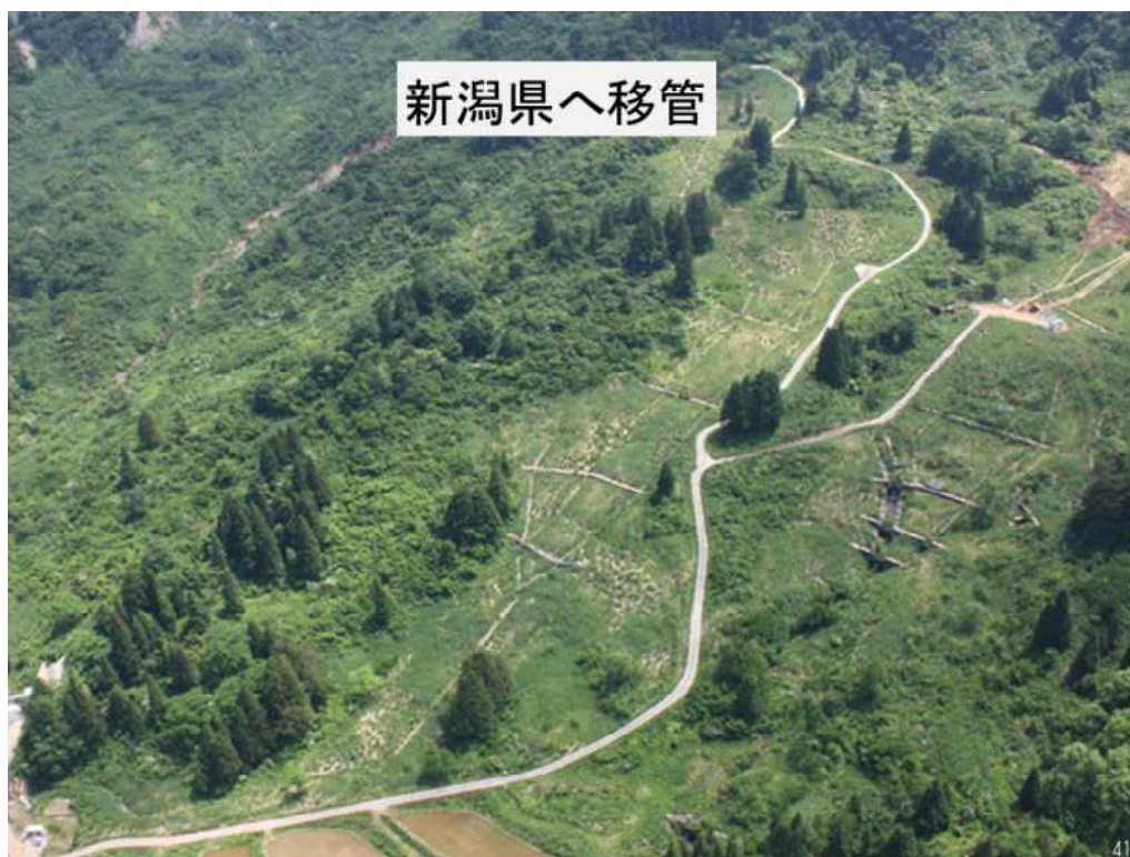
地すべり対策の工事完了後、地すべりは発生することなく、緑も回復してきている (写真中央付近で傾斜に沿った白い筋は、水路工施工箇所)
