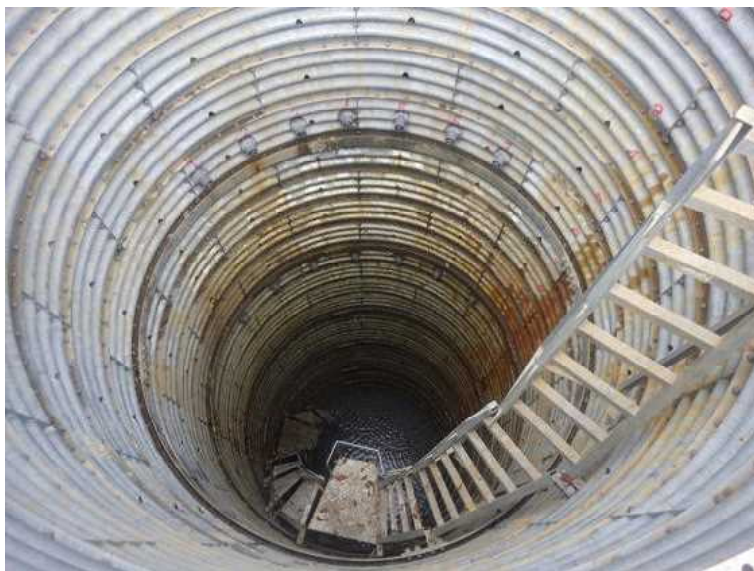
細いパイプを通して抜かれてきた地下水は、井戸の底に集められ、集水に用いたものとは別なパイプでもって排水されていく
