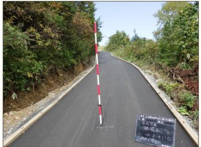
小松原林道改良工事（R 4 補正）
