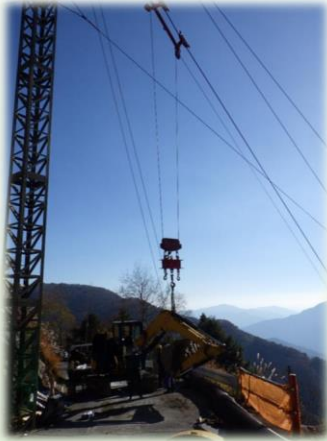
ケーブルクレーン
