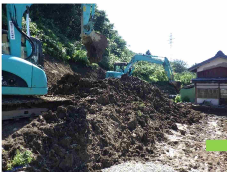
被災状況（村上市荒島地区）
