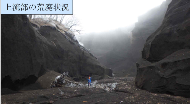
被災した既設床固工（手前からNo.3, 4, 5）
