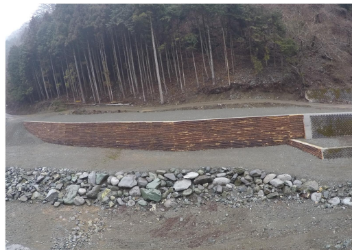
水の木幹線林道改良工事 (H26補正) (東京神奈川森林管理署)
