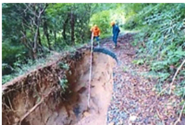
林道の被害状況調査
