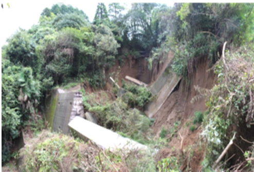
山腹崩壊と治山施設の被災状況
