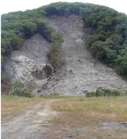
法面崩落災害（戸倉山） （平成23年7月）
