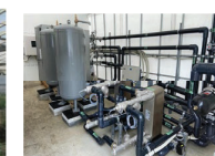
木質資源利用ボイラー
