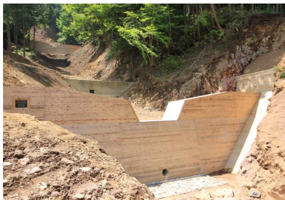
木製型枠を使った谷止工（那須塩原市上ノ原）
