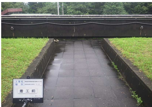
コンクリート目地の劣化状況
