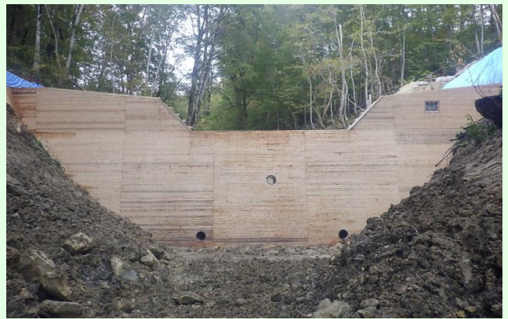
間伐材を利用した治山施設
