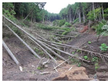
④ 角取山工区荒廃状況(近景)
