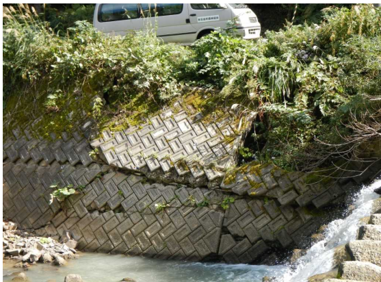
④ 護岸工に生じた変状
