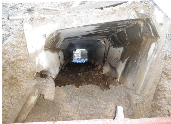
⑤ 町道横断水路工に生じた変状
