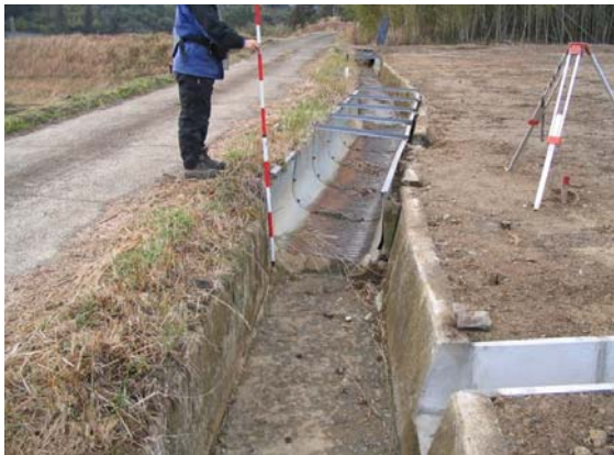
① 農業用水路の変形
