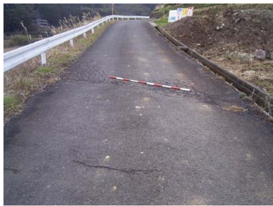
② 市道の亀裂
