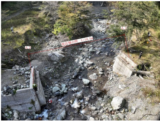
既設橋台状況（上部工は完全流出）
